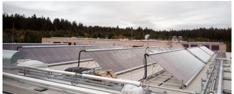
Vakuumröhrenkollektoren auf dem Dach eines Brauereigebäudes
