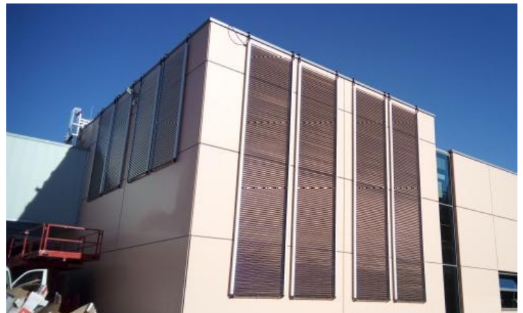
Vakuumröhrenkollektoren an der Fassade eines Brauereigebäudes
